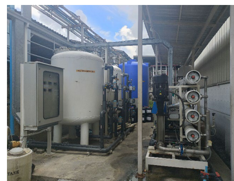
SATLの水リサイクル設備
